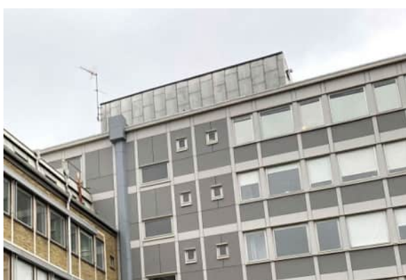
Ovan foto som visar den ursprungliga fasaden på byggnadslängan utmed Fabriksgratan. Den är fackindelad, har fönsterband och bröstningar av korrugerad aluminiumplåt. Observera kulörernas kontraster. Nedan foto på innergården sedan fasaderna renoverats. Källa: Örebro kommun
