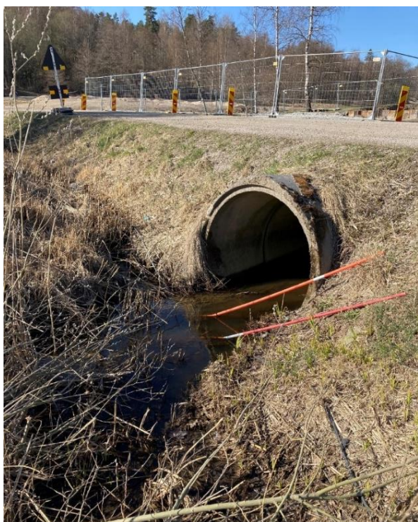
Figur 18. Trumma vid utlopp i sydvästra delen om området, under Sörbyvägen. Foto: WSP
