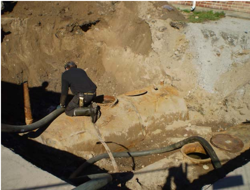
Foto 4.3. Fotot illustrerar de två cisterner som lämnats kvar i mark
