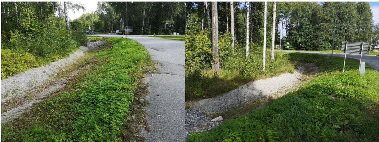
Figur 25. Läge E, t.v. visar utlopp från planområdet och läge F, t.h. visar dike vid Sanatorie-rondellen.
