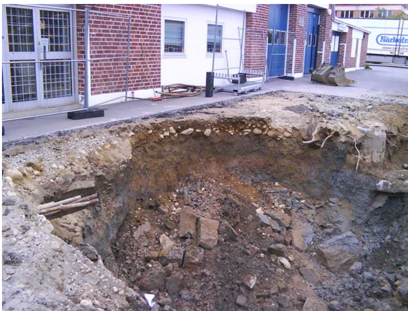
Foto 4.1. Vy mot nordväst. Till vänster syns de ledningar som ledde söderut mot cisternerna.
