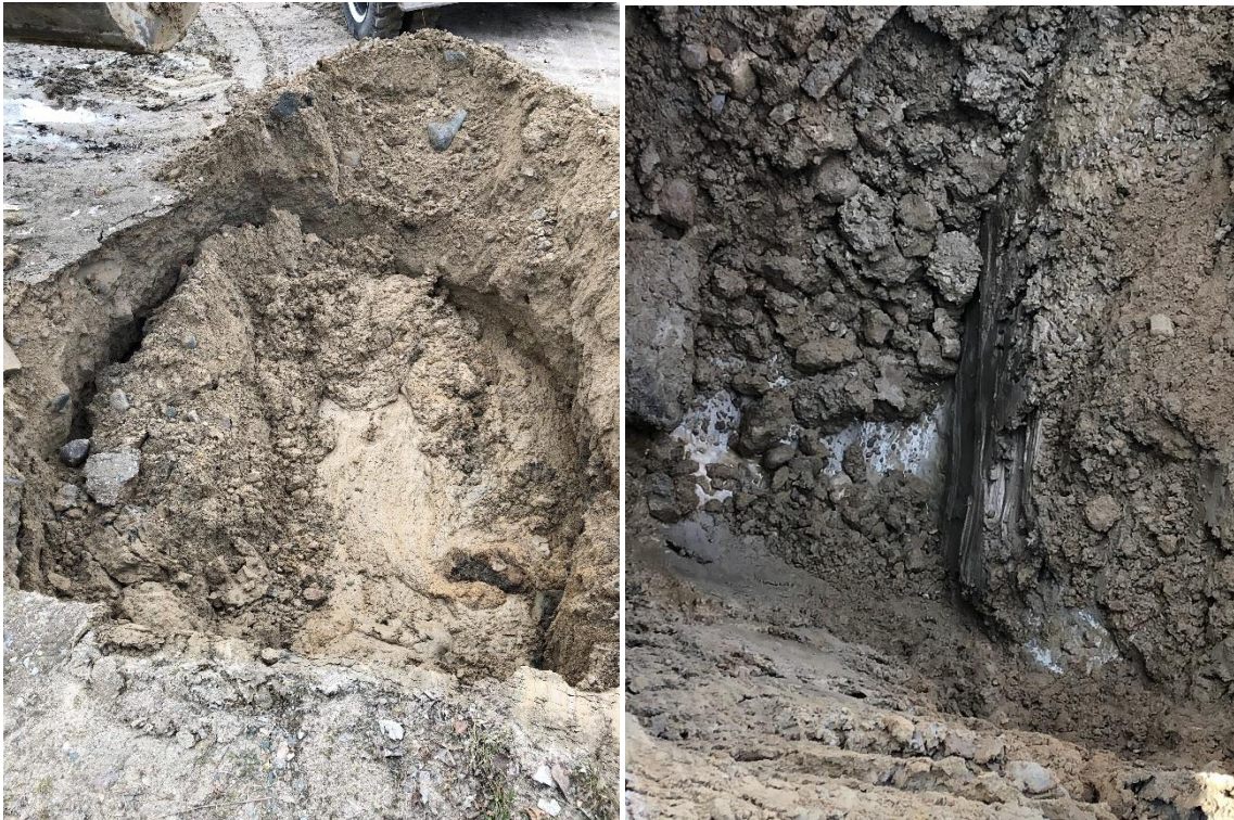
Figur 5.1 Till vänster SM21_15 provgrop rasar igen på grund av ny fyllning samt vatten. Till höger SM21_12 oljehinna noteras i botten
