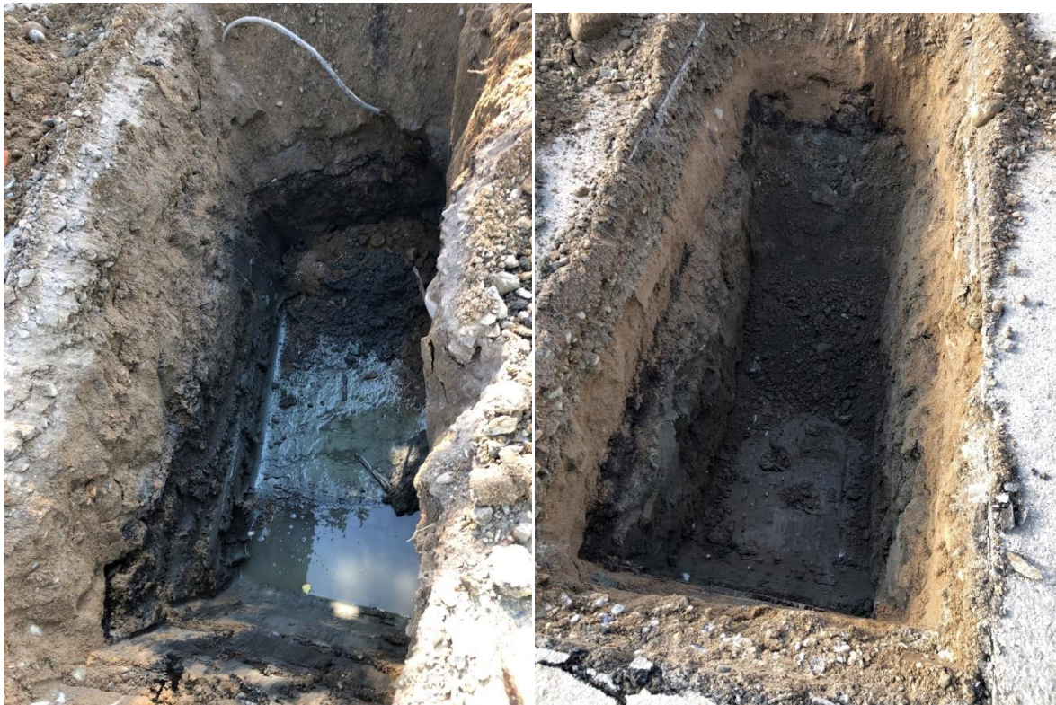
Figur 6.1 Till vänster SM2, avbruten kabel. Till höger mörkt skikt på 0,5–0,7m.
